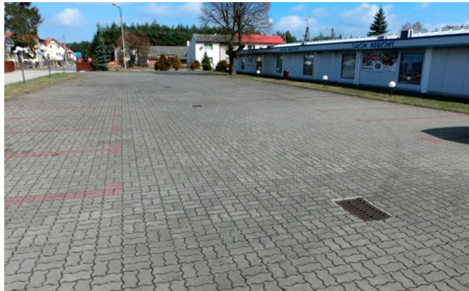
Rys. 2. Widok nawierzchni parkingu wykonanego z kostki betonowej na podbudowie z pianobetonu po 20 latach użytkowania
